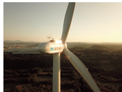
aeru電気に電力を供給する発電所のひとつ唐津市湊風力発電所 (写真提供:自然電力)
